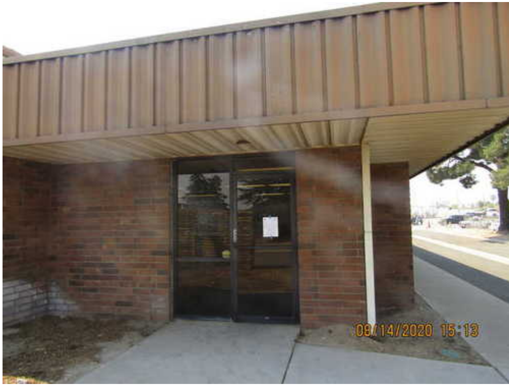
5770 Industrial Pkwy - Posted NOV (3).JPG
